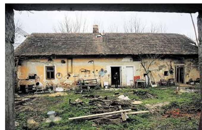
Magorův statek O obnovu zchátralé hospodářské usedlosti v Prostředním Vydří se snaží občanské sdružení založené letos v létě jeho třemi dětmi.
